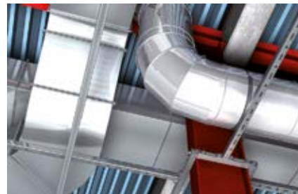
Опорные конструкции для крепления вентиляции
